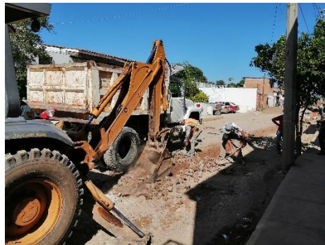
Imagen 2.5. Obra de extensión de tubería 8" circuito principal de agua potable en calle Hidalgo.
