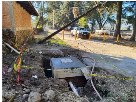
Imagen 2.1. Caja de válvulas tipo 2 – Rancho San Nicolás.
